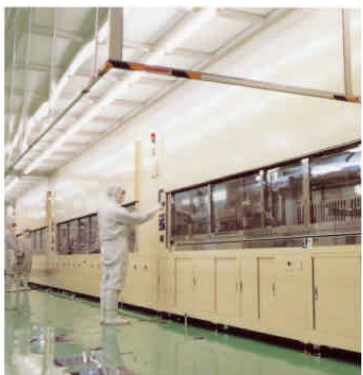
クリーンルーム Clean Room
